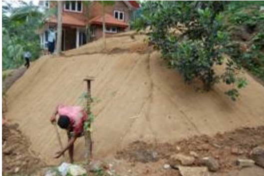
Protection of Hill Slope (Kallar)
